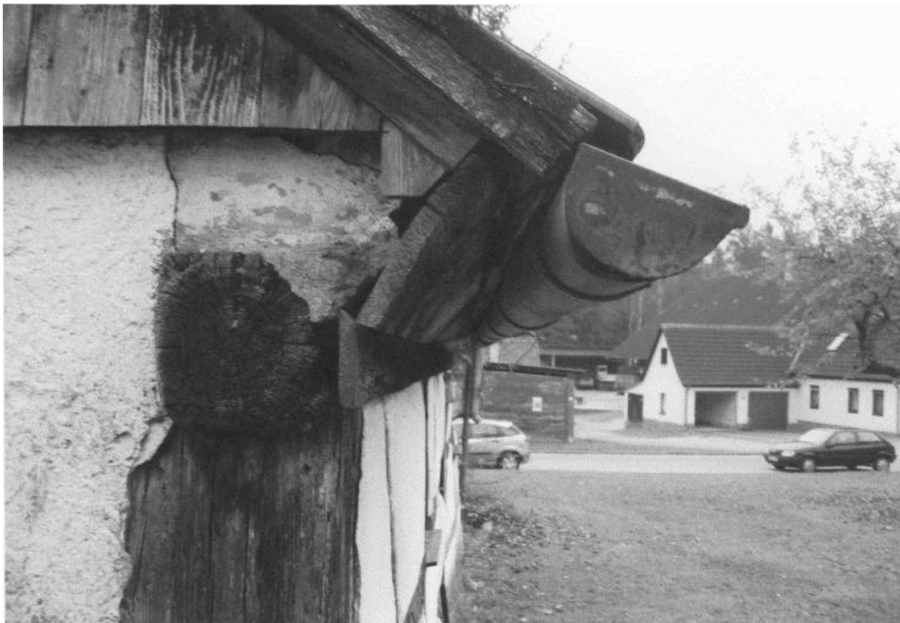
Abbildung 21 Detail Nord-West Seite Zeigt die Traufe und das hervorstehende, einst verputzte Rahm
